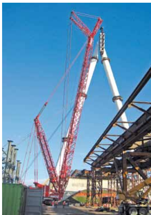
Figura 15 - Assieme autogrù da 750 t in fase di sollevamento della camera di ancoraggio
