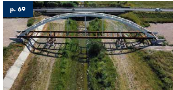
p. 69 Pasarela peatonal y para bicicletas sobre el río Satanasso. Villapadana - Italia - Longitud 64,5 m 2023
