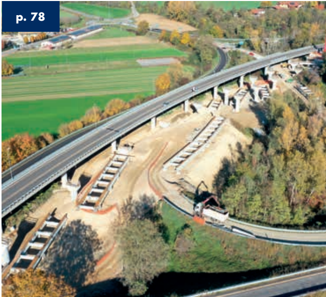
Viadotti Tangenziale di Fossano Tratto S.S. 231 "di Santa Vittoria"- Italia - Lunghezza 780 m
